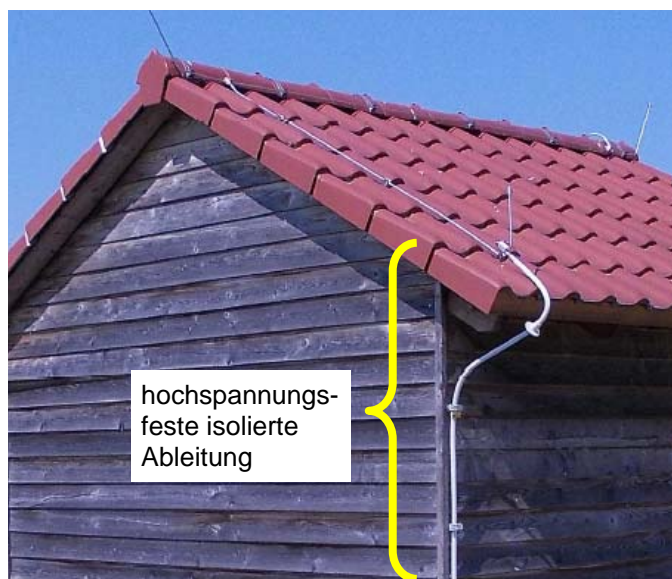
Bild 9: Schutzhütte mit hochspannungsfester isolierter Ableitung
