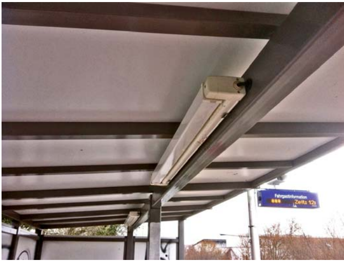
Bild 11: Wartehäuschen mit elektrischer Beleuchtung
